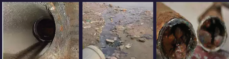
Chemical Sewage Pipes Paip Kumbahan Kimia
